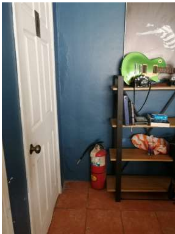
Ilustración 60. Falta de señal del extintor y sus instrucciones dentro de la agencia
