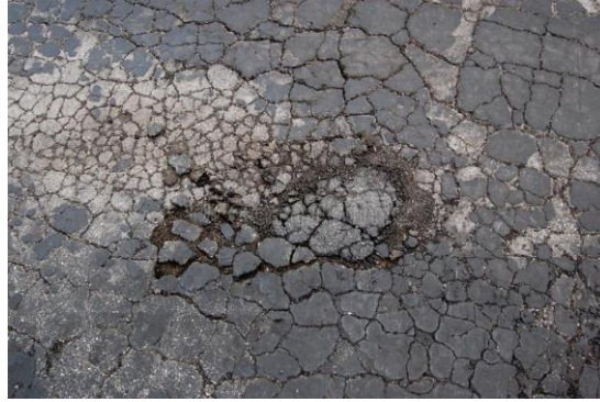
Ilustración 10. Desprendimiento de agregados
