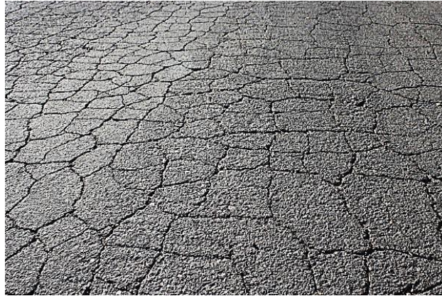
Ilustración 14. Agrietamiento piel cocodrilo
