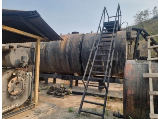
Ilustración 80. Tanque de cemento asfáltico en Santos Industria
