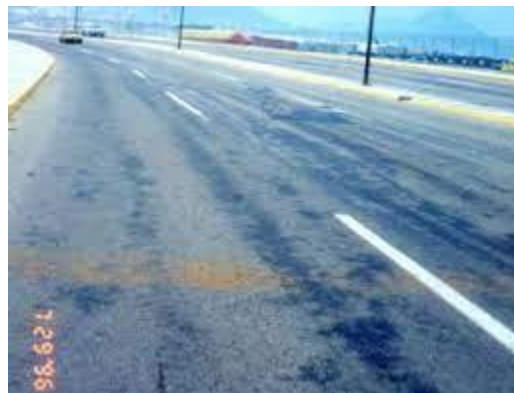
Ilustración 15. Llorado de asfalto
