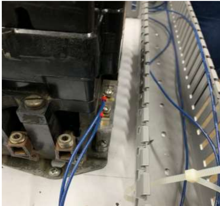
Ilustración 31. Conexión de Cables.
