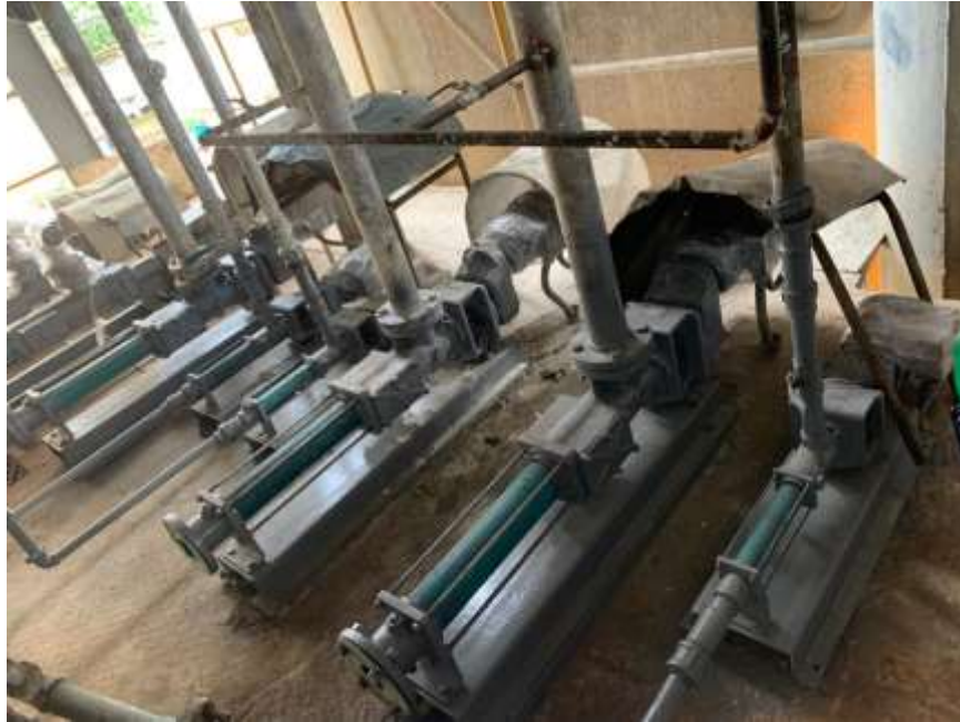
Ilustración 28. Motores de bombas de floculante y cal.
