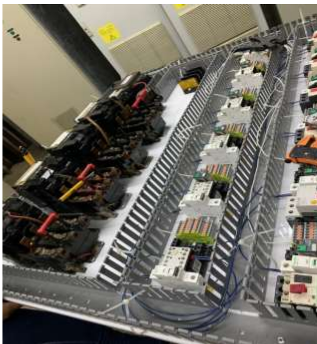
Ilustración 32. Panel de Control de Condensadores.
