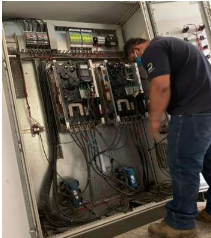
Ilustración 16. supervisión de mantenimiento de paneles de control
