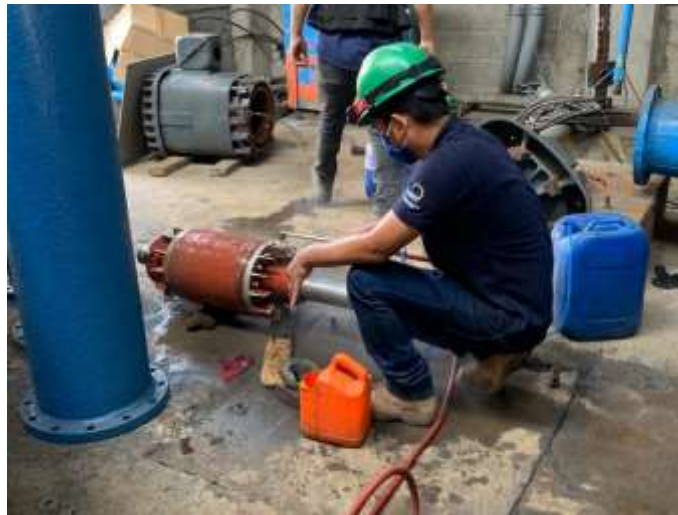
Ilustración 17. Mantenimiento a motores
