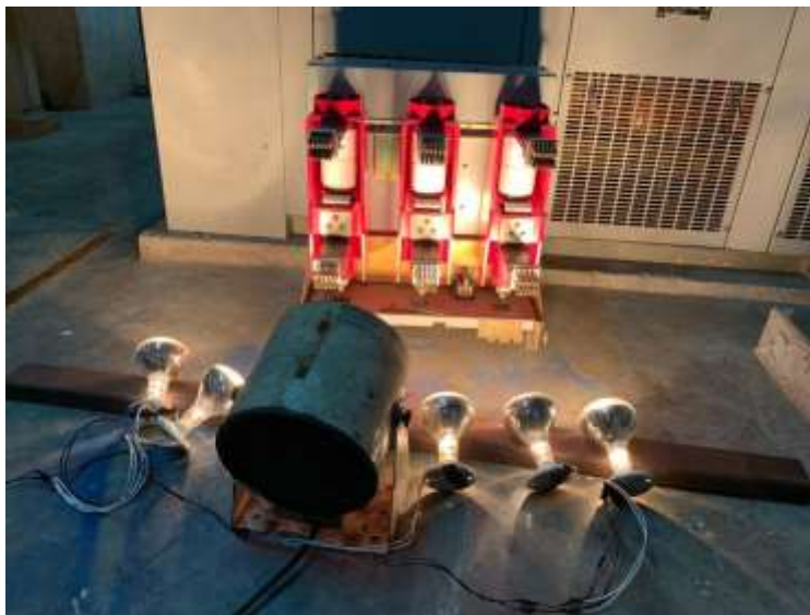
Ilustración 14. Calentamiento de Disyuntores en vacío
