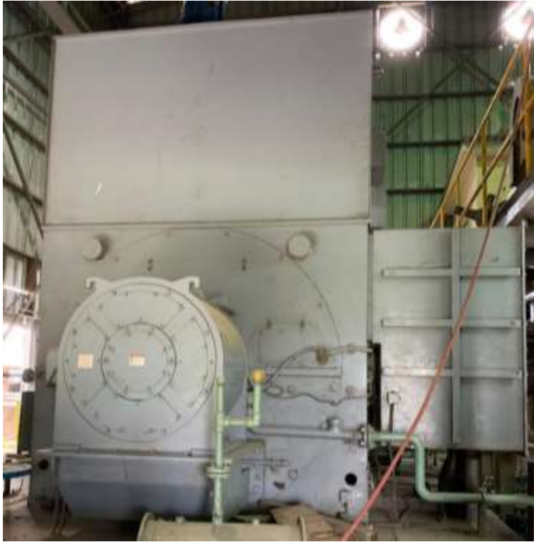
Ilustración 7. Generador Shin Nippon Machinery
