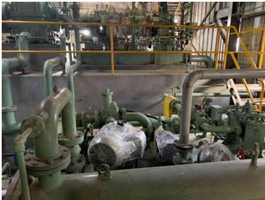
Ilustración 34. Motores del generador Shin Nippon.
