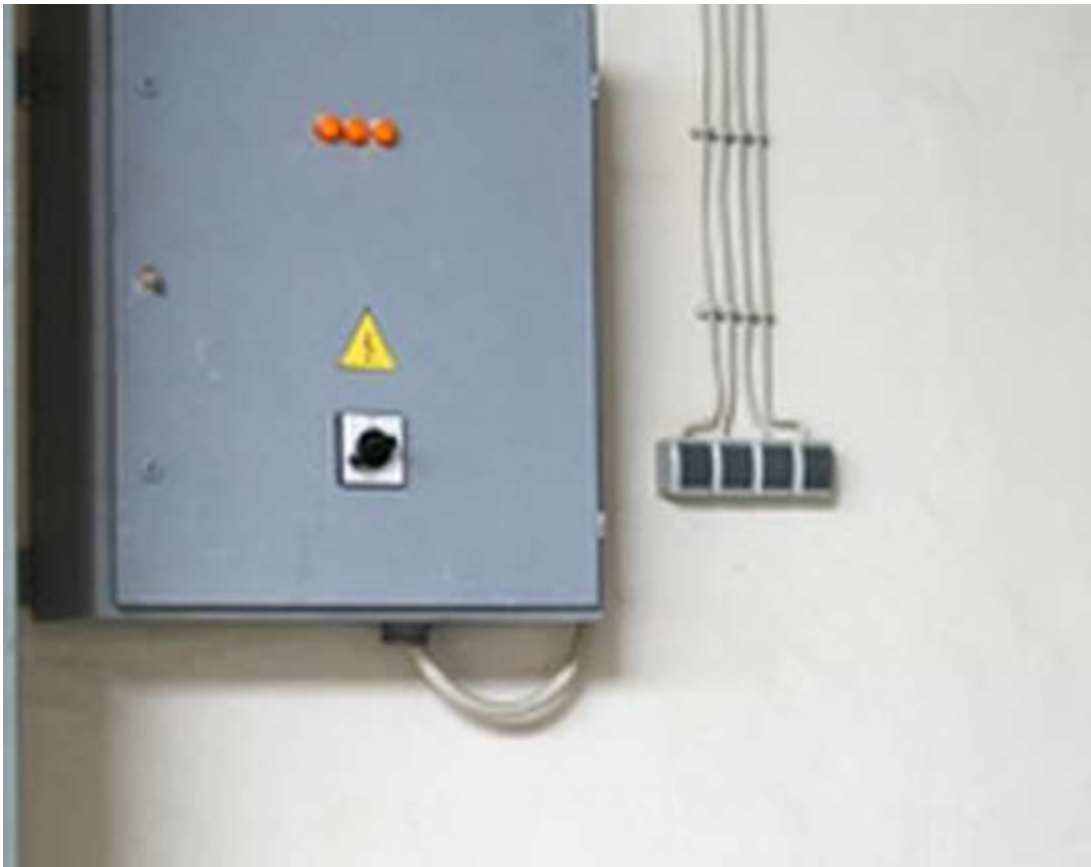
Ilustración 3. Panel de control.
