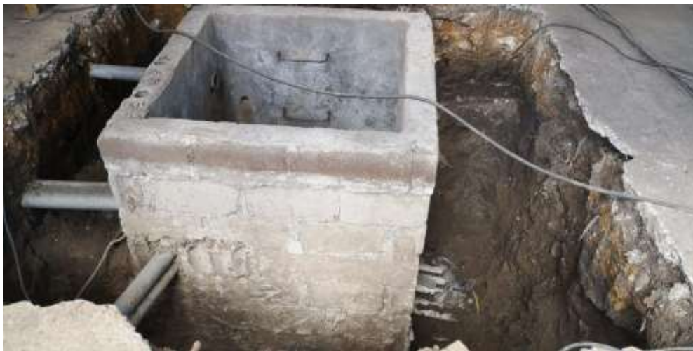
Ilustración 11. Cajas de registro eléctrico
