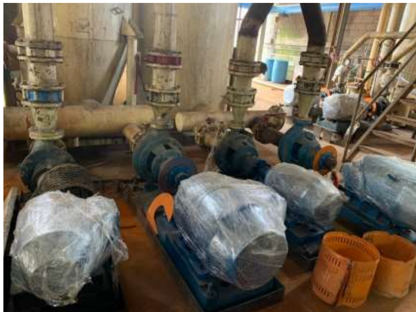
Ilustración 29. Motores de bombas de Meladura.
