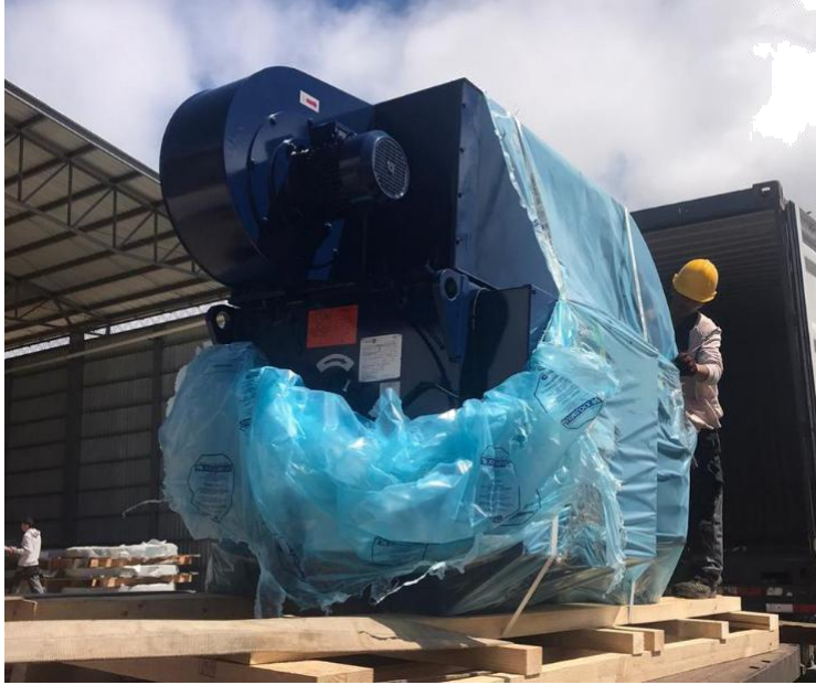
Ilustración 8. Descarga nuevo Generador
